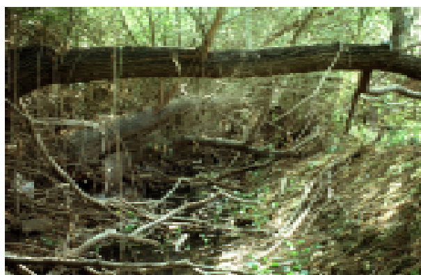
Vala colmatada e obstruída.
